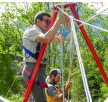
Der Bau einer improvisierten Seilbahn über den Averser Rhein ist aufwändig und erfordert Fachwissen.
